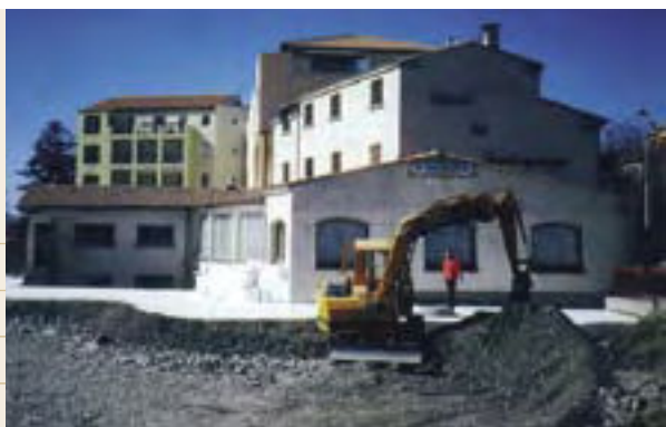
Photo 6 : remblai contre les fondations d'une habitation
