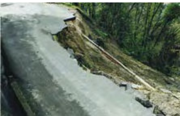
Photo 3 : exemple de glissement de terrain sur pente
