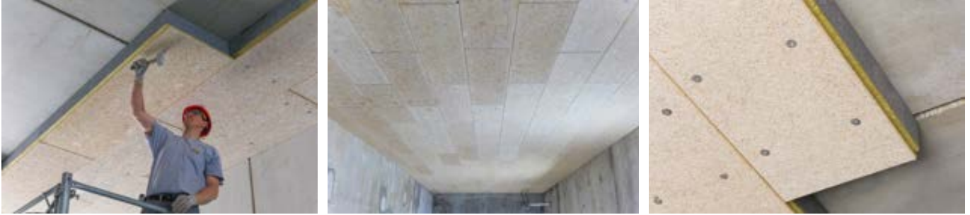
Panneaux Stisolith® Ultra LR Meca posés sur le chantier Le Parallèle à Courbevoie (92) par l'entreprise GCC
